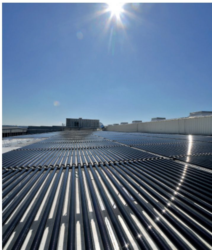
Instalacja solarna na dachu zakładu.
